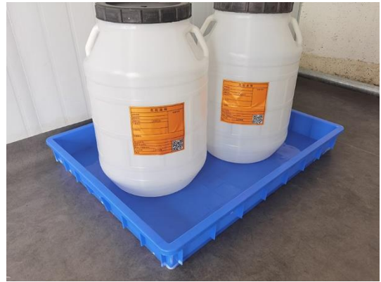
危废贮存间托盘及防渗
