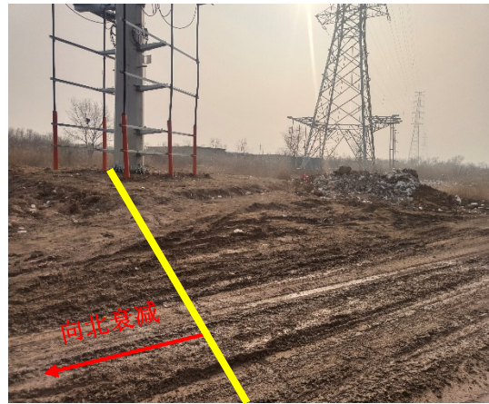
图 7-4 110kV 蒲泉线、110kV 蒲尧线双回电缆输电线路衰减
